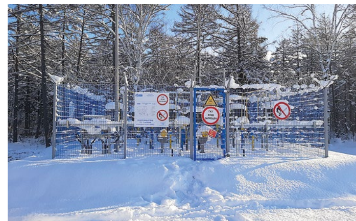
Газопровод-отвод и ГРС «Тымовское» Сахалинской области
