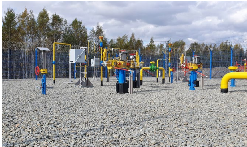
Магистральный газопровод «Сахалин-Хабаровск-Владивосток». Крановый узел
