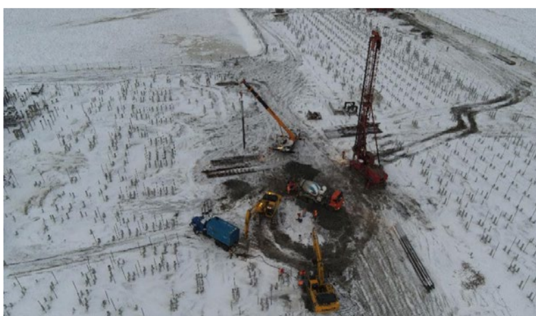
Харасавэйское ГКМ. Площадка установки комплексной подготовки газа
