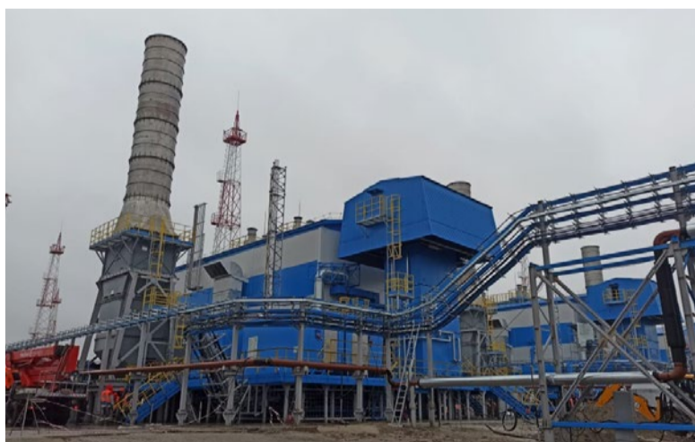
Бованенковское НГКМ. Дожимная компрессорная станция
