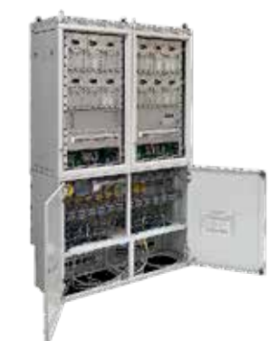
Станция катодной защиты
