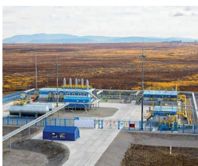
Газораспределительная станция (ГРС)
